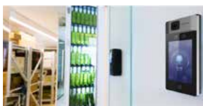
Terminal com suporte em parede para controle de acesso
